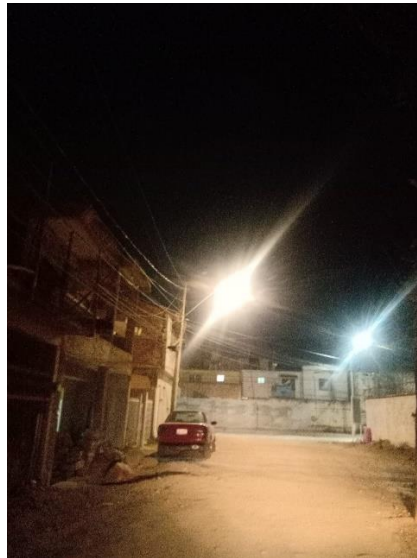
Figura 5. LUMINARIA DE VSAP EN LA COLONIA RIVERA DEL RÍO
